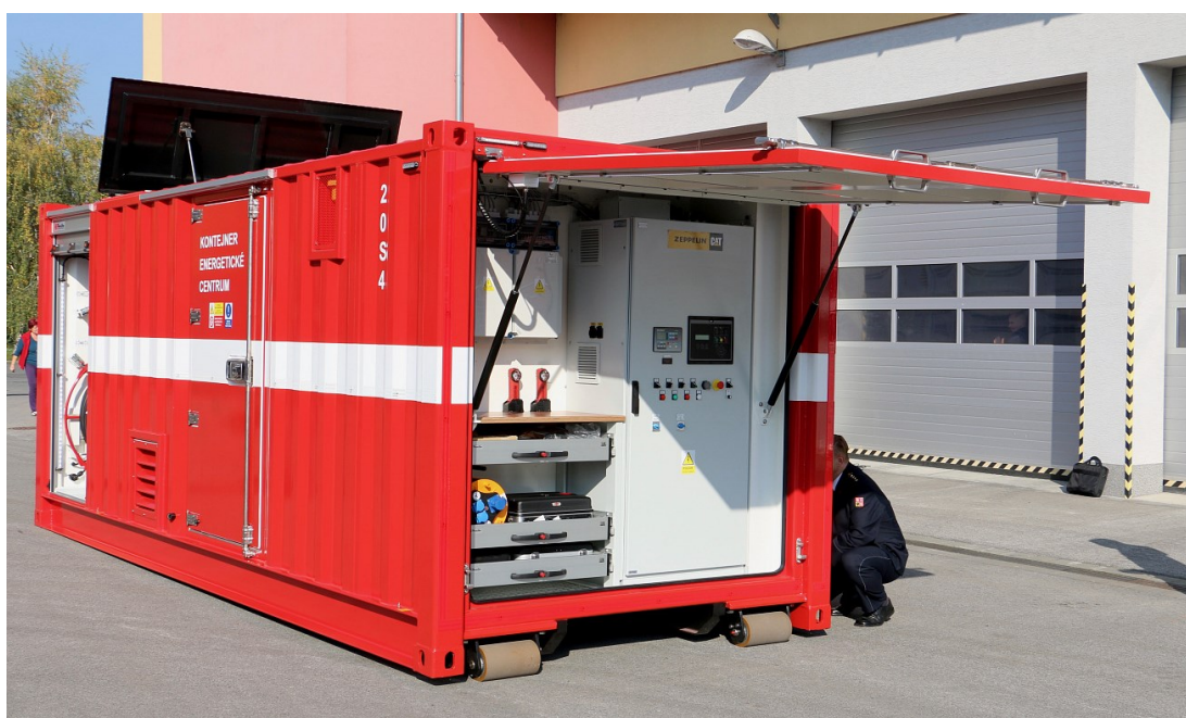
Obrázek 19: Kontejnerové energetické centrum u HZS Olomouckého kraje, (Hacsiková, 2017)
