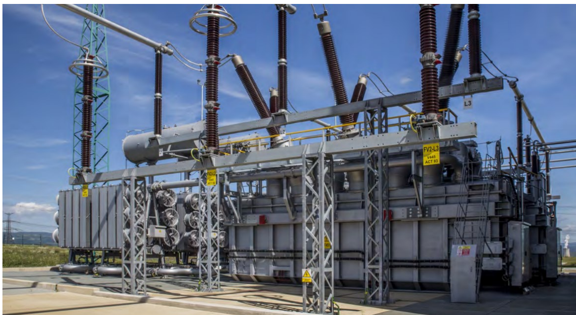
Obrázek 5: PST transformátor v rozvodně Hradec u Kadaně, (ČEPS, © 2017)
