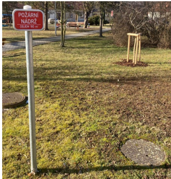
Obrázek 5 – Podzemní nádrž (vlastní)
