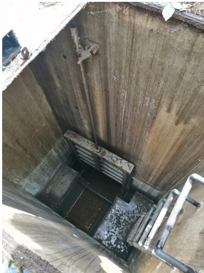
Obrázek 4 Kanalizační hradítko na kanalizaci.
