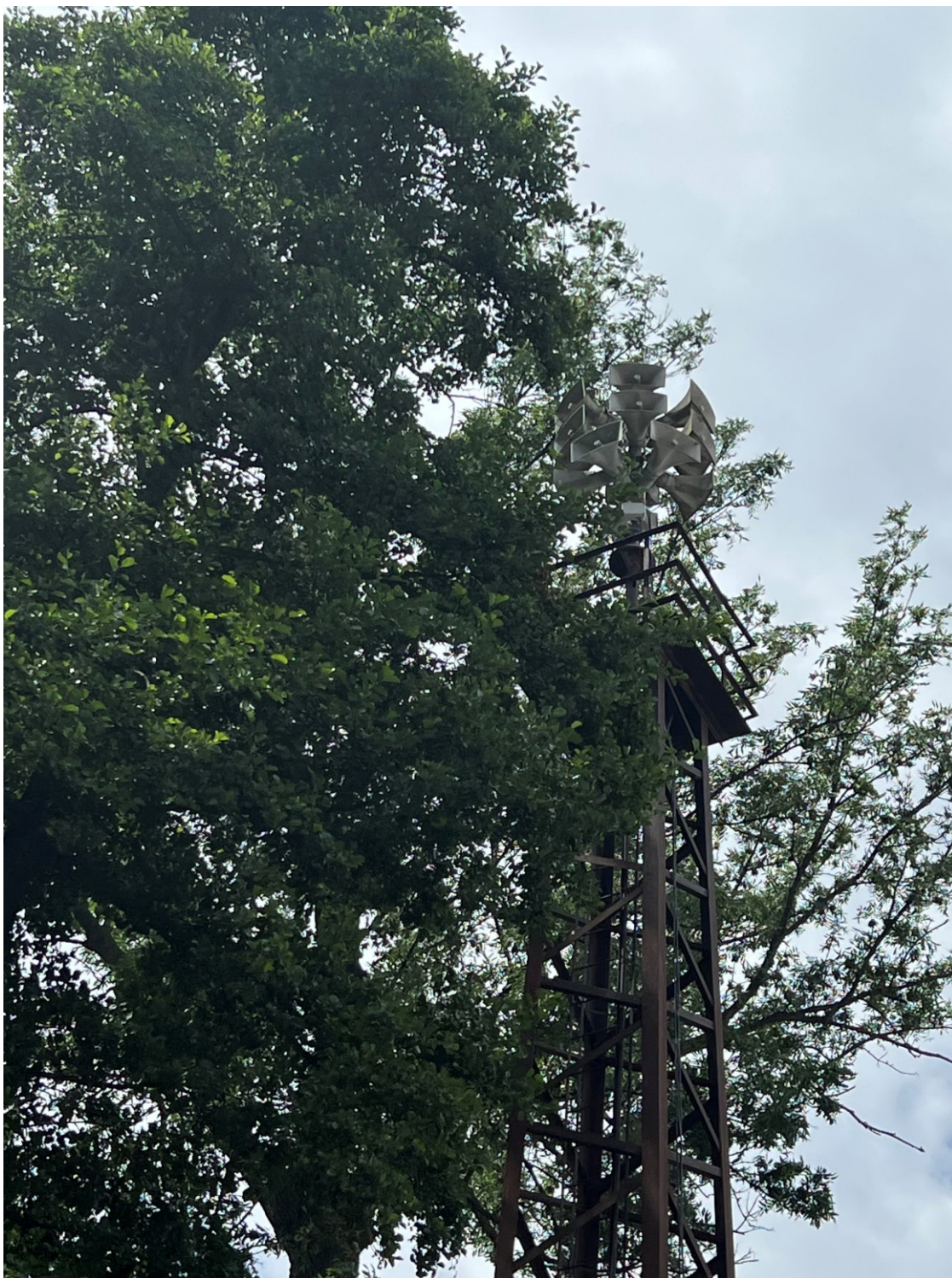
Obrázek 21 Elektronická siréna na dvoře obecního úřadu (Vlastní zdroj, 2022)
