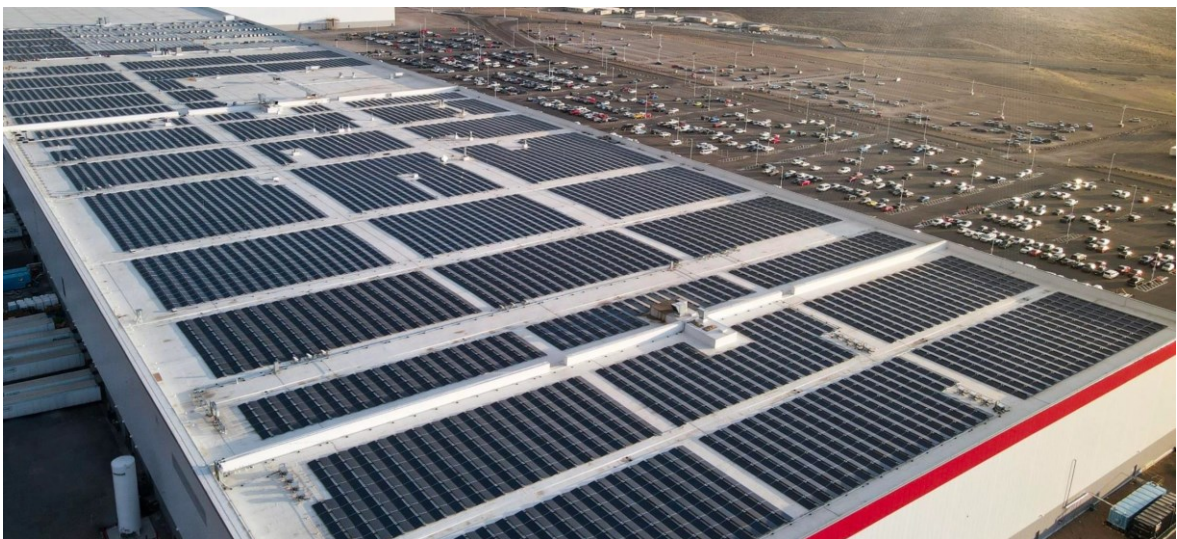
Obrázek 4 Solární panely na továrně Giga Nevada (© Electrek.co, 2022)
