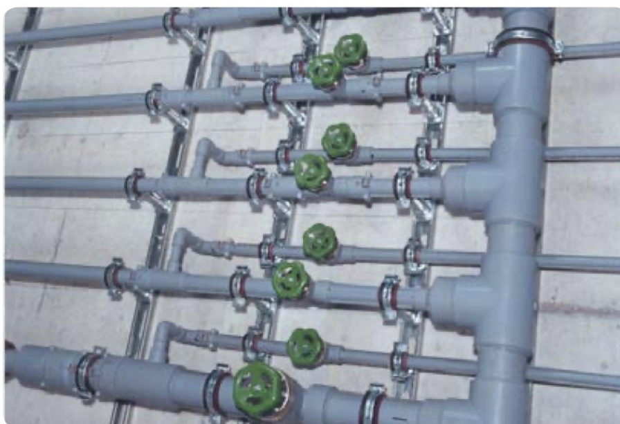
Obrázek 8 Vodovodní rozvody z iPB-1 [25]
