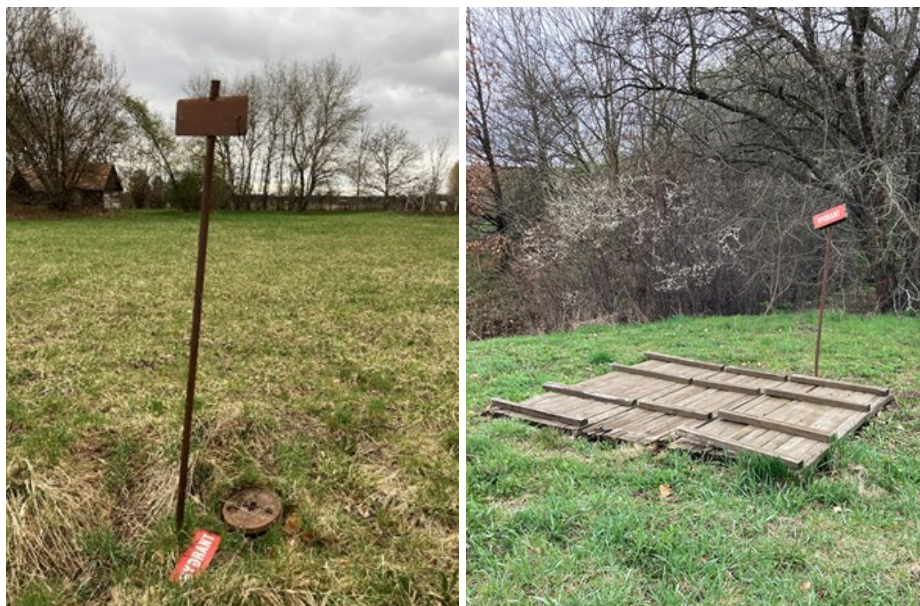
Obrázek 21 – Podzemní hydranty uvnitř areálu muzea (vlastní)
