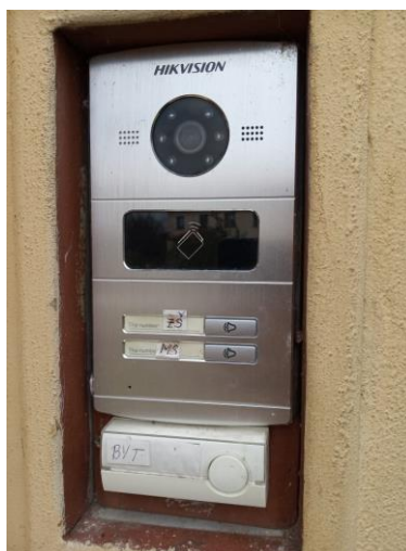
Obrázek 9 Access control systém (vlastní, 2022)
