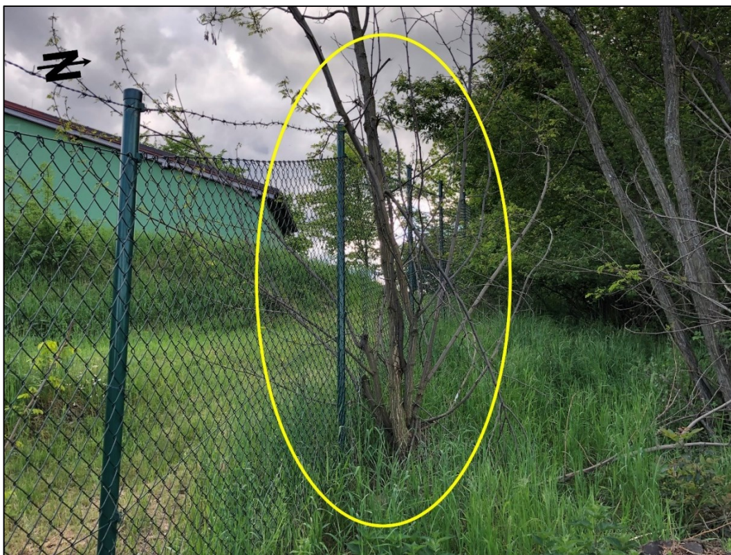
Obrázek 14 Vodojem – prorůstání náletových dřevin do oplocení [vlastní]
