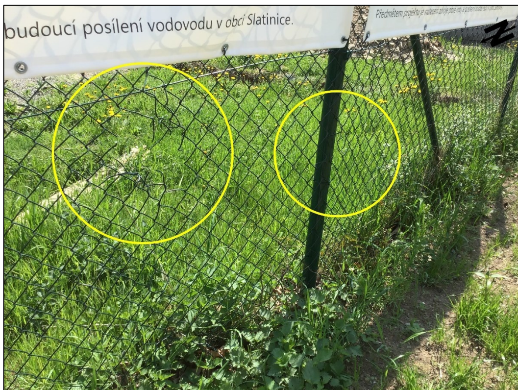
Obrázek 15 Vodojem – protržení oplocení na západní straně [vlastní]
