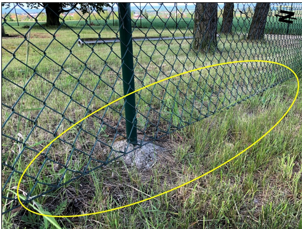
Obrázek 19 Vrty HV 1, 2 – vyháknutí spodního napínacího drátu po celé délce oplocení [vlastní]
