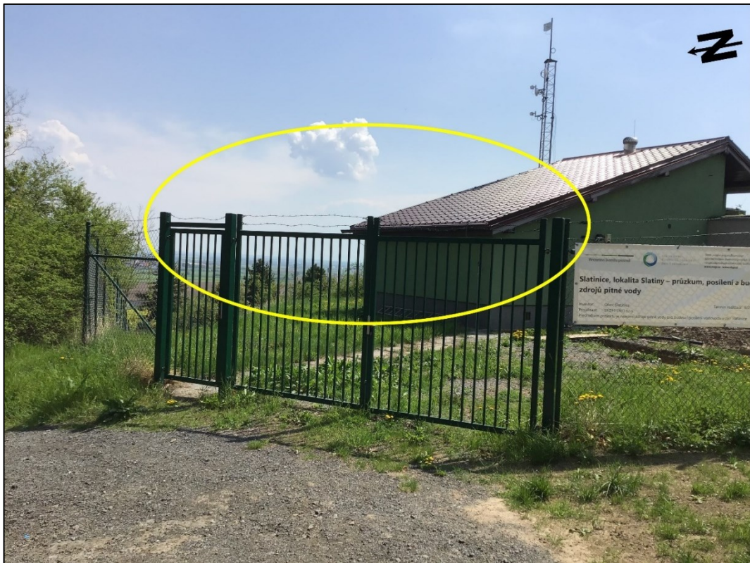
Obrázek 12 Vodojem – nevhodně zvolený systém vrcholových zábran [vlastní]
