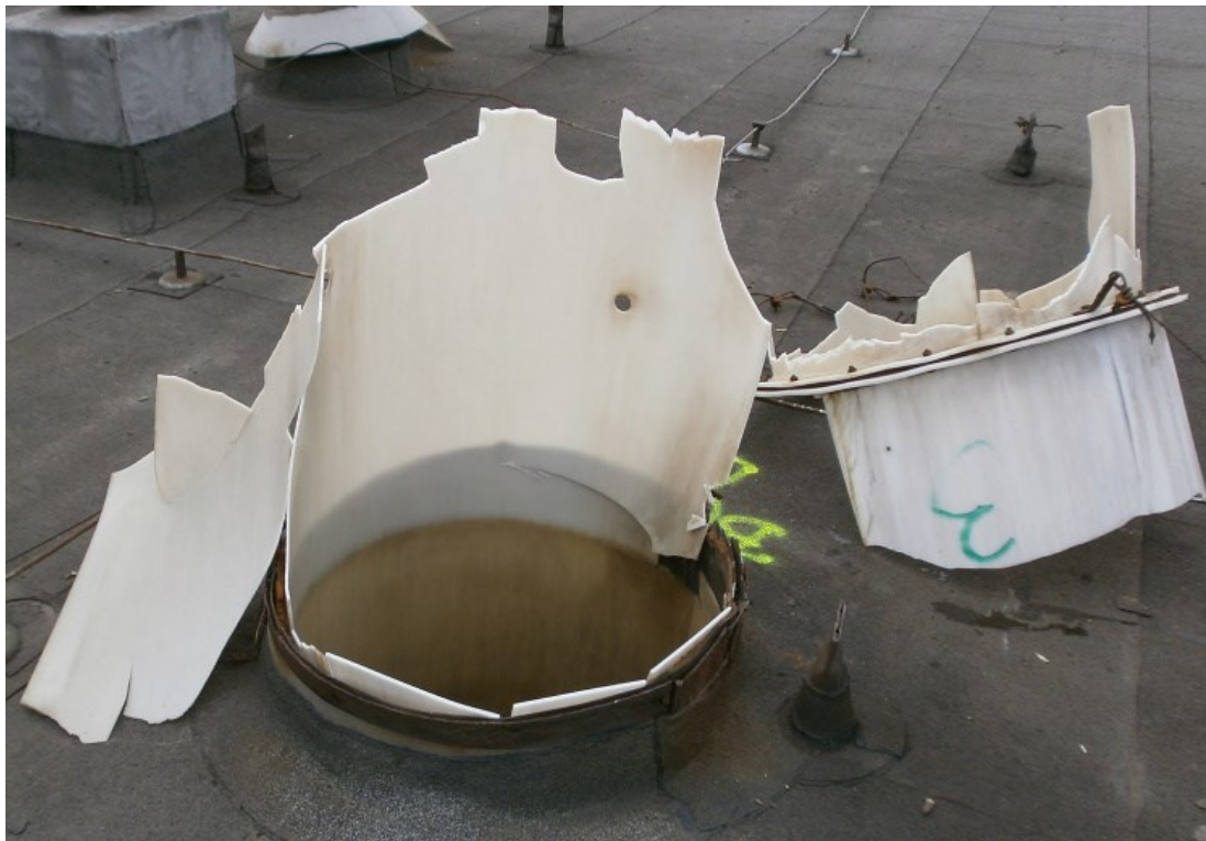
Obrázek 13 Degradace potrubí z PP způsobená vlivem UV záření a vzduchu. [35]
