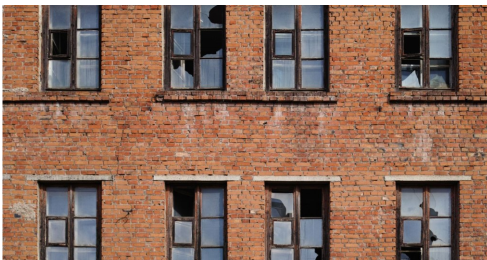
Obr. 1. Budova s rozbitými okny [7]
