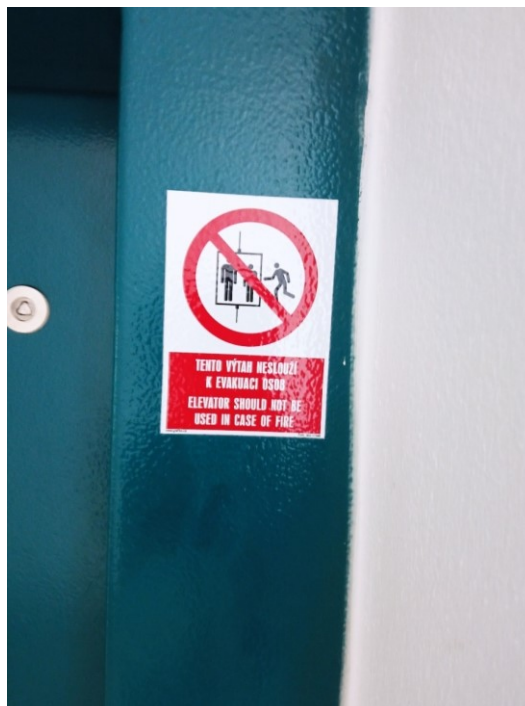
Obrázek 9 – Informační tabulka na dveřích výtahu [Zdroj: vlastní zpracování]
