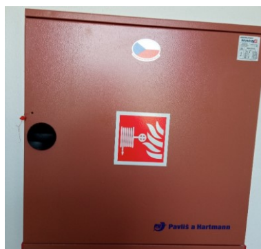
Obrázek 21– Požární hydrant [Zdroj: vlastní zpracování]
