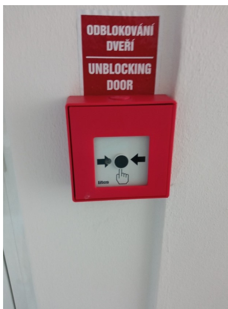
Obrázek 12 – Nouzové tlačítko odblokování dveří [Zdroj: vlastní zpracování]
