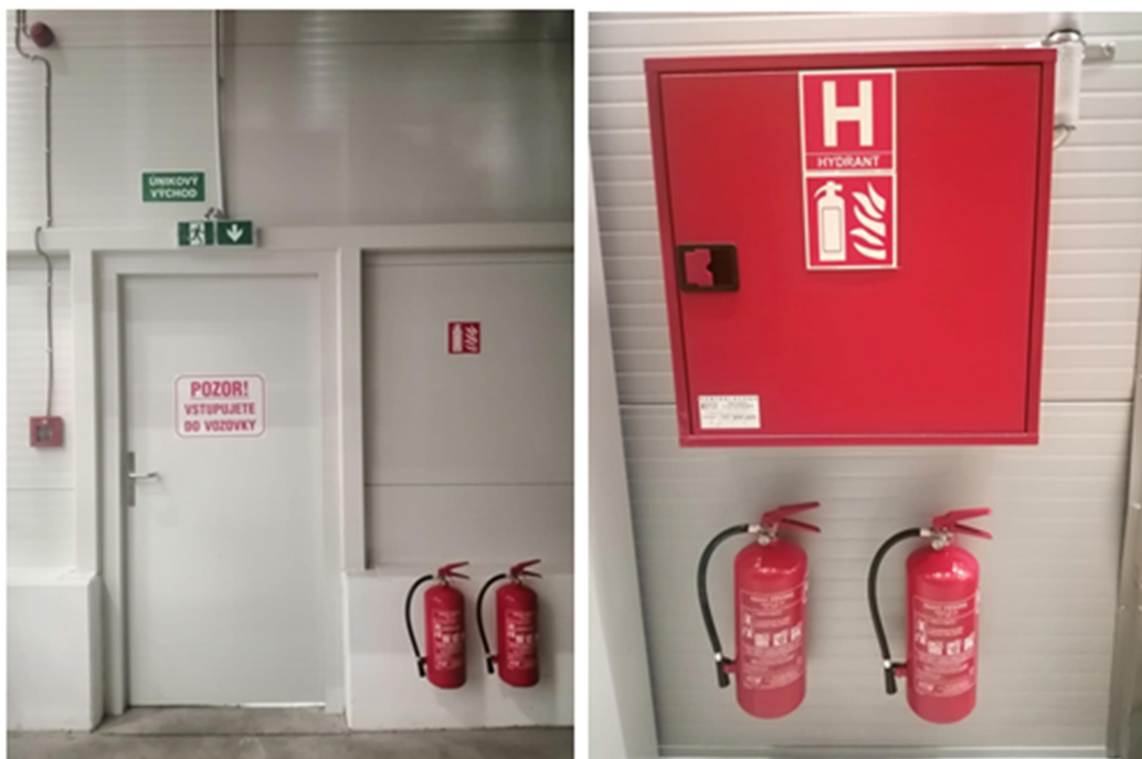
Obrázek 24 Únikový východ, hasící přístroje a hydrant (vlastní)
