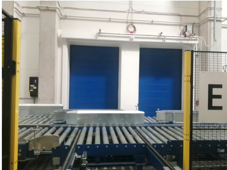
Obrázek 19 Vrata u válečkové dráhy pro vyskladnění a zaskladnění palet (vlastní)
