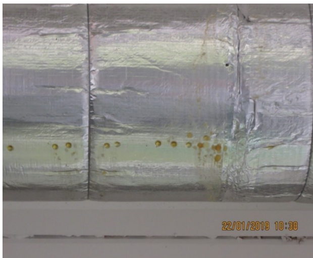
Obr. 29 Kondenzace oleje na vzduchotechnice [27]
