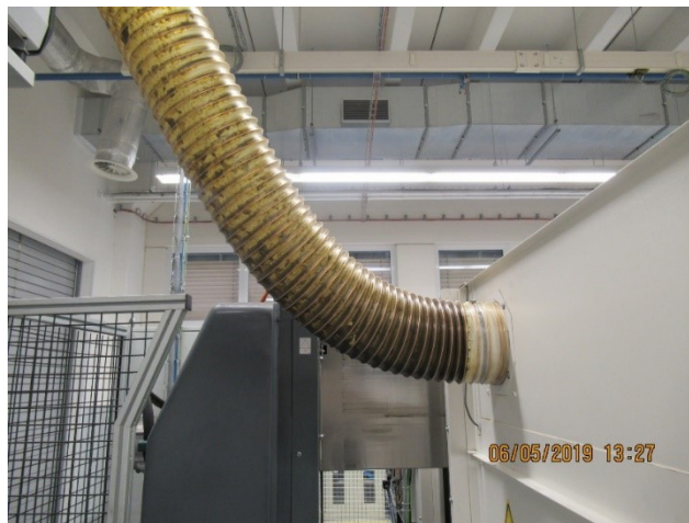
Obr. 50 Znečištění odsávacího potrubí [27]
