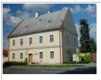
Obr. 12. Farní budova pochází z roku 1620. Od tohoto roku dvakrát vyhořela a prošla několika opravami. Poslední oprava byla v roce 1993. V roce 2002 byla provedena izolace zdiva proti vlhkosti.
