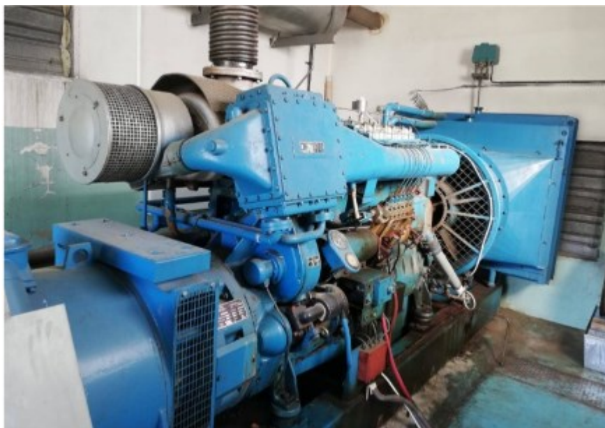
Obr. 13 Záložní zdroj 300kw [Zdroj: Fotoarchiv nemocnice]
