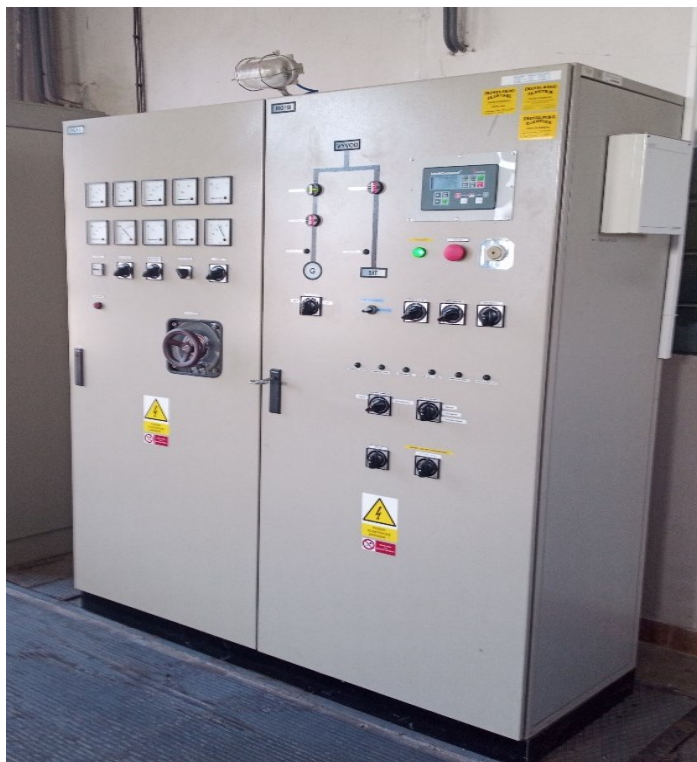
Obr. 7 Ovládací centrum dieselgenerátorů [Zdroj: Vlastní]
