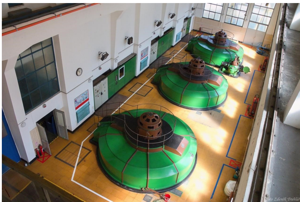
Obr. 15 Generátory Vranovské vodní elektrárny [Zdroj:[47]]
