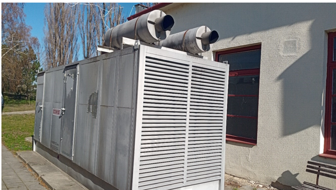
Obr. 8 Záložní zdroj 805kw [Zdroj: Vlastní]
