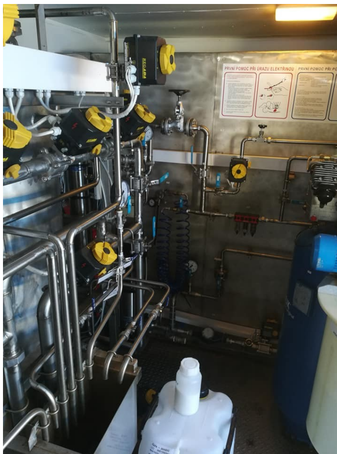
Obrázek 32 - Kontejnerová úpravná vody. FOTO: Autor.
