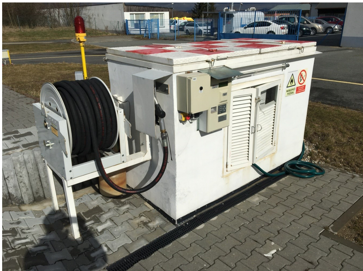
Příloha 7 – Výdejový stojan čerpací stanice
