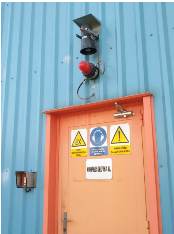
Obrázek 11 Plynový detekční systém nad vstupem do kompresorovny opatřen světelným značením v případě zvýšené koncentrace zemního plynu. [zdroj vlastní]
