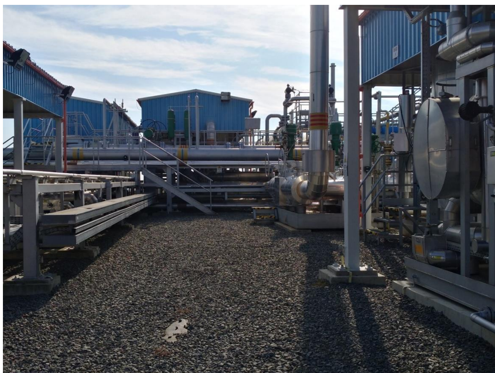
Obrázek 13 Barevné označení potrubních cest v sektoru úpravy plynu. [zdroj vlastní]
