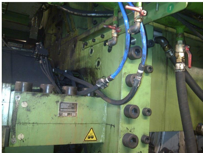
Obrázek 4 Úprava zapojení hadic chlazení na věžovou vodu (vlastní zpracování)
