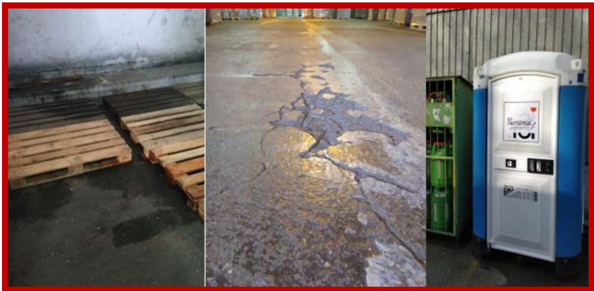
Obrázek 31 - Vytyčené nedostatky - zatékání, podlaha a toaleta (vlastní zpracování)
