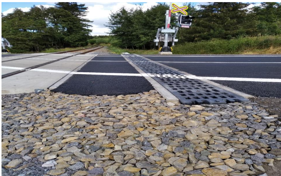
Obrázek 10. Nevhodné směrové a výškové uspořádání přejezdu
