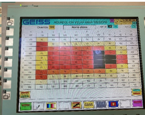
PP6 Ohrev na prevádzkovú teplotu
