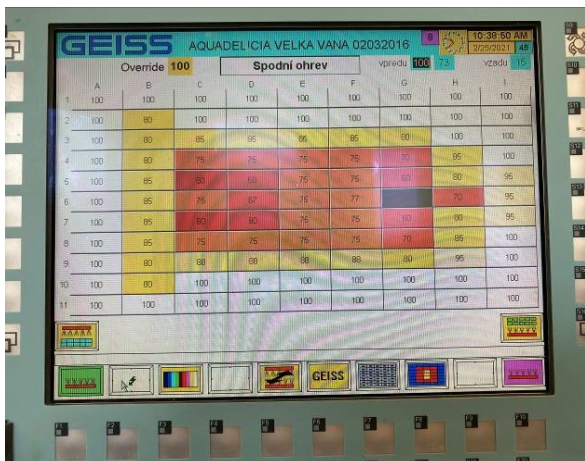
PP6- Ohrev na prevádzkovú teplotu
