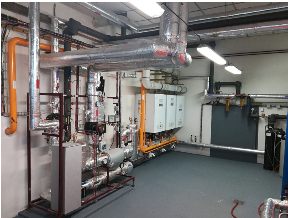
Obr. 8. Plynová kotelna se závěsnými kotli [vlastní]
