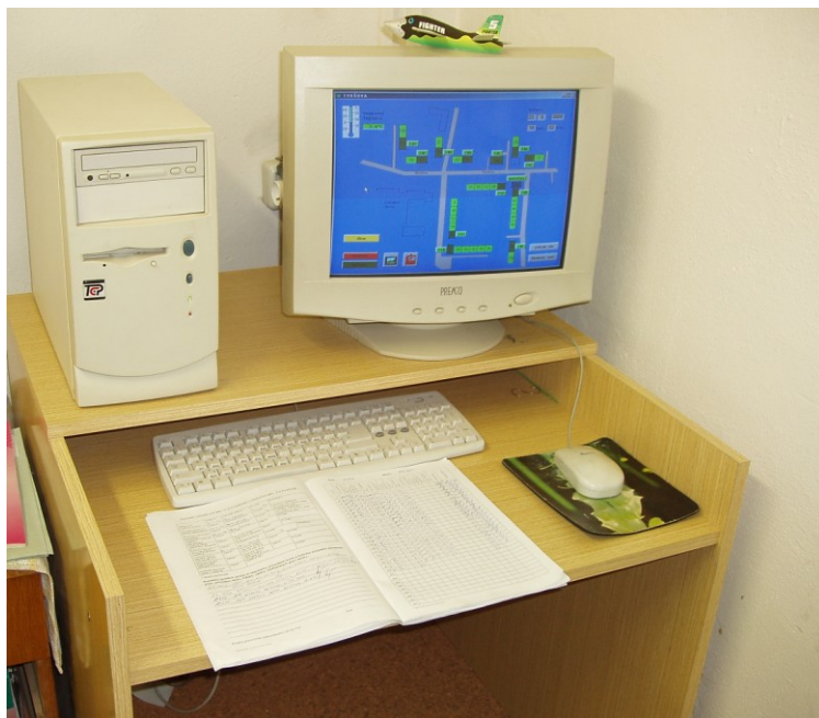
Obr. 37. Pracoviště s PC (místnost obsluhy) [vlastní]
