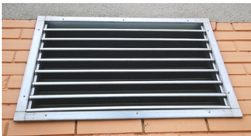
Obr. 40. Větrací otvor do kotelny s mřížkou [vlastní]
