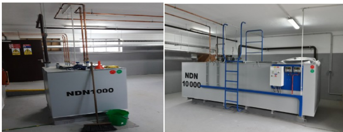
Obr. 6. Nádrže s topným olejem [upraveno z 13]
