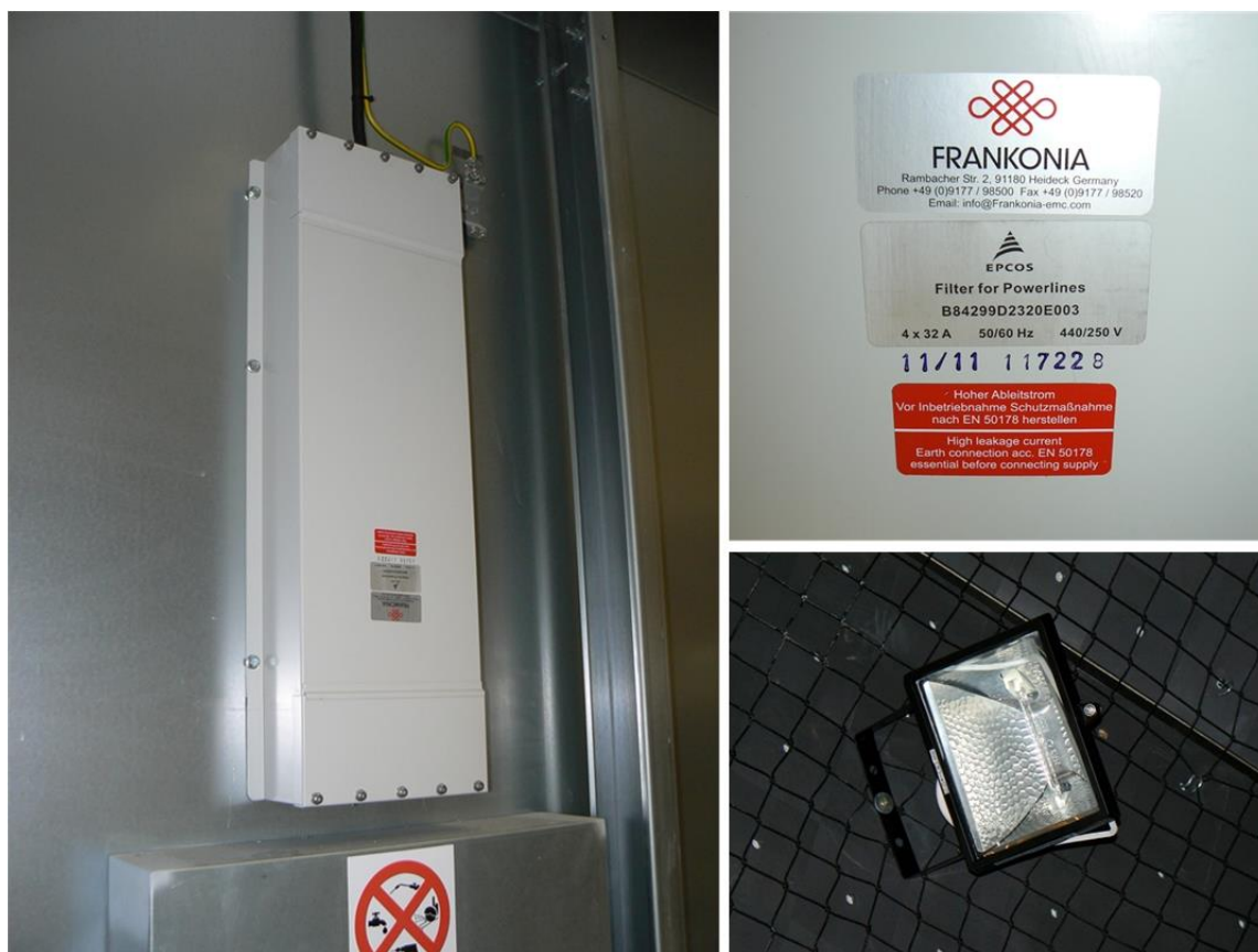
Obr. 4.3: EMC filtr EPCOS – B84299 a halogenové osvětlení v komoře
