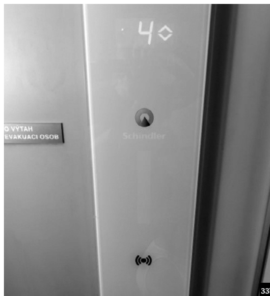
Obr. 33a–b Ovládání výtahu
