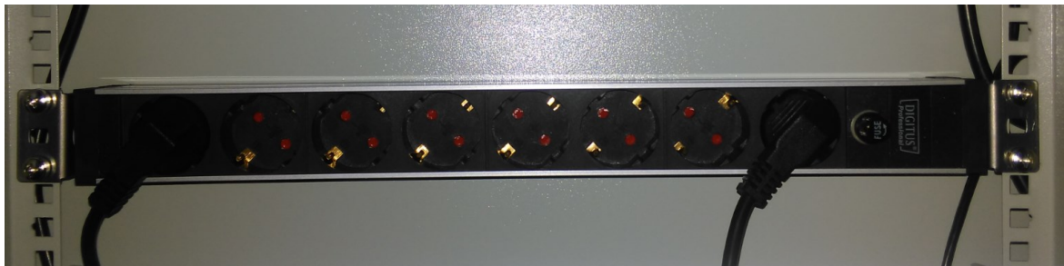
Obrázek 24 – PDU lišta – napájení routeru a switche
