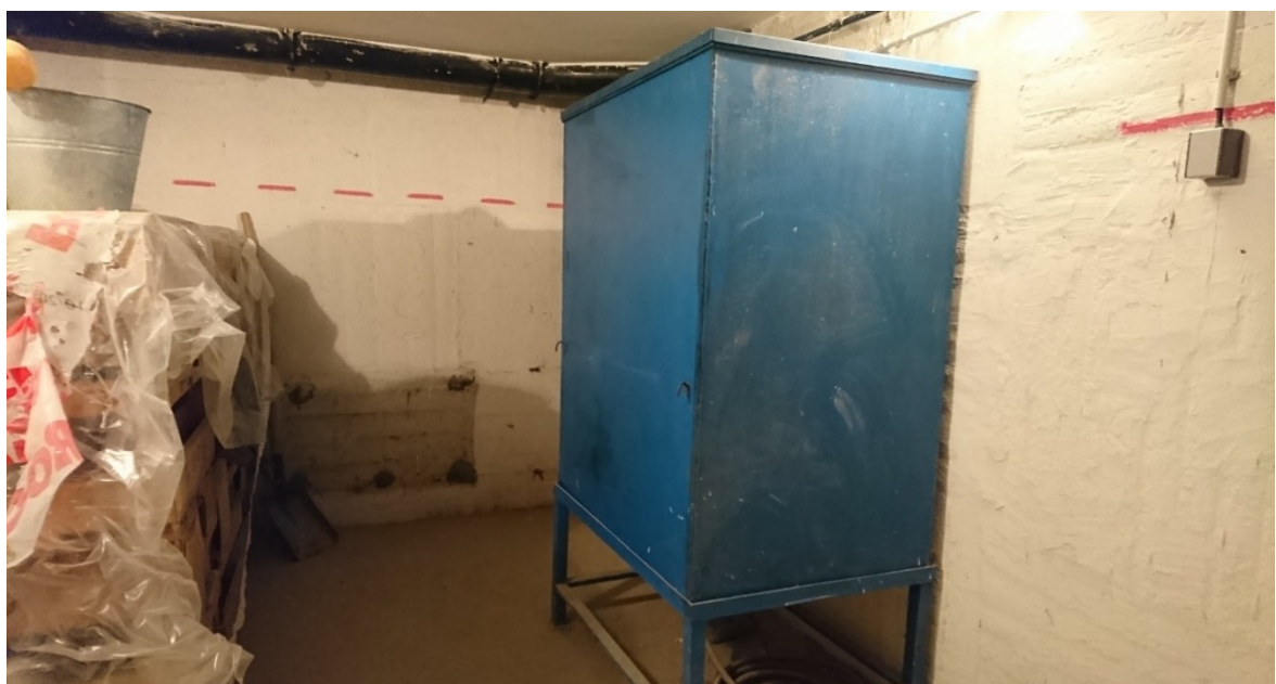
Obrázek 59 – nádrž na vodu. [32]
