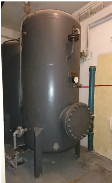
Obrázek 44 – nádrž na vodu [32]
