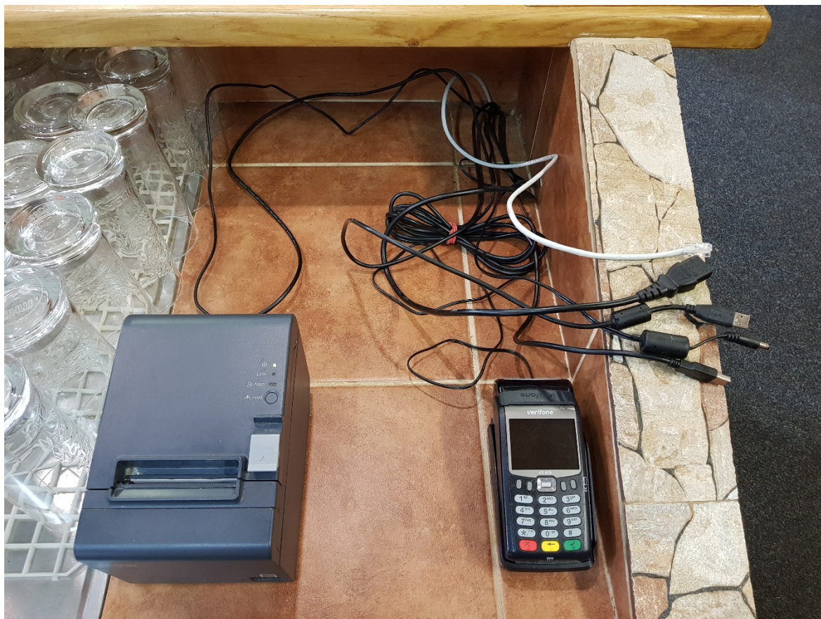
Obrázek 71: Zapojení tiskárny účtů Epson Epson TM-T20II, příprava kabeláže k propojení se serverem.
