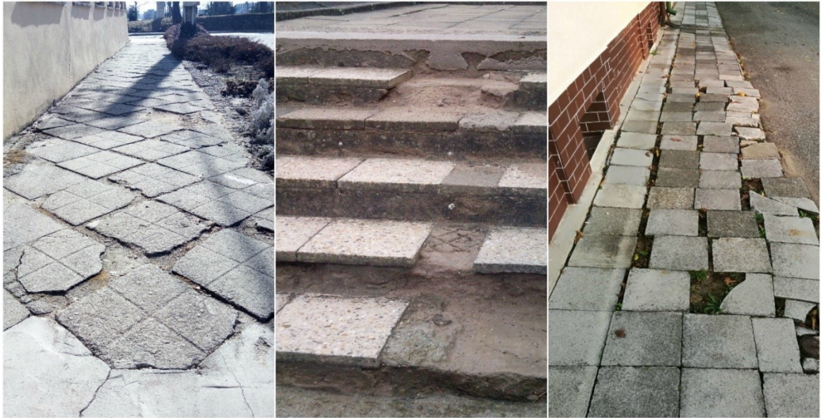
Obrázek 20: Chodníky a schodiště v havarijním stavu
