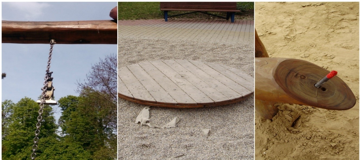
Obrázek 29: Poškozené herní prvky
