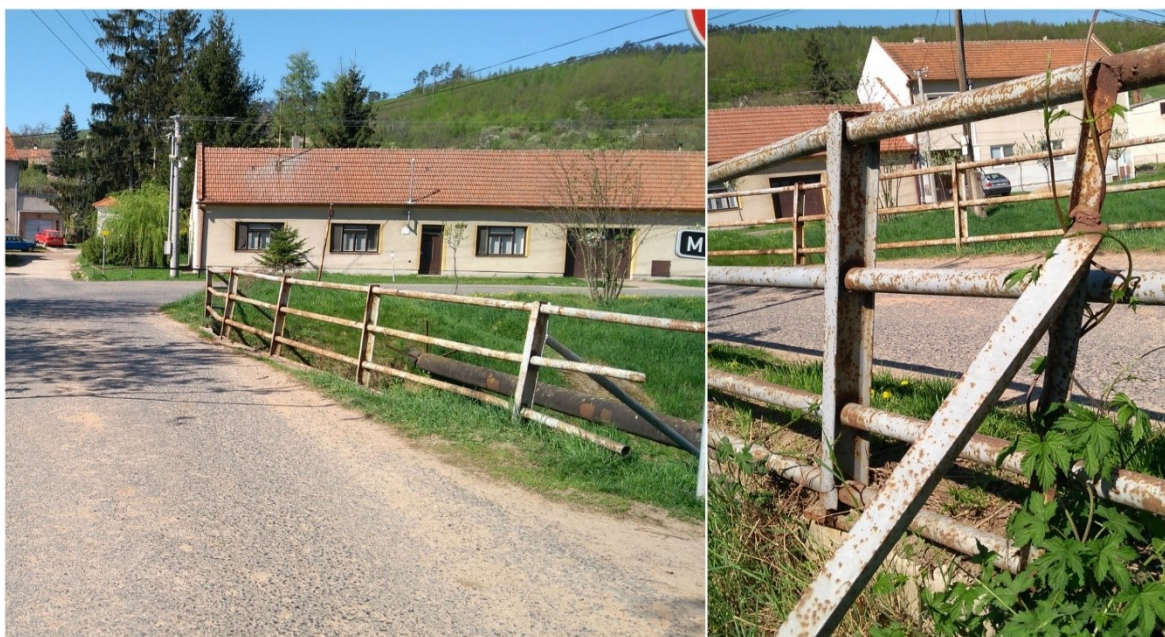
Obrázek 18: Nenormové mostní zábradlí v havarijním stavu
