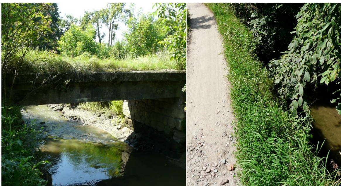
Obrázek 19: Most přes vodní tok bez zádržného systému (zábradlí)
