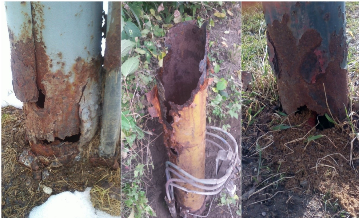
Obrázek 22: Defekty stožárů VO způsobené korozí
