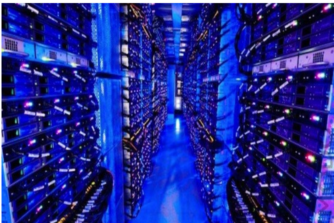
Obrázek č.5 Datacentrum
