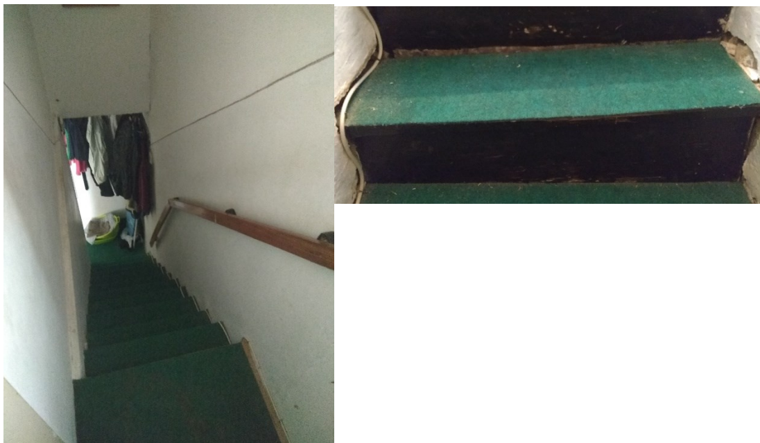
Obrázek 20 – Schodiště a poškozený schod
