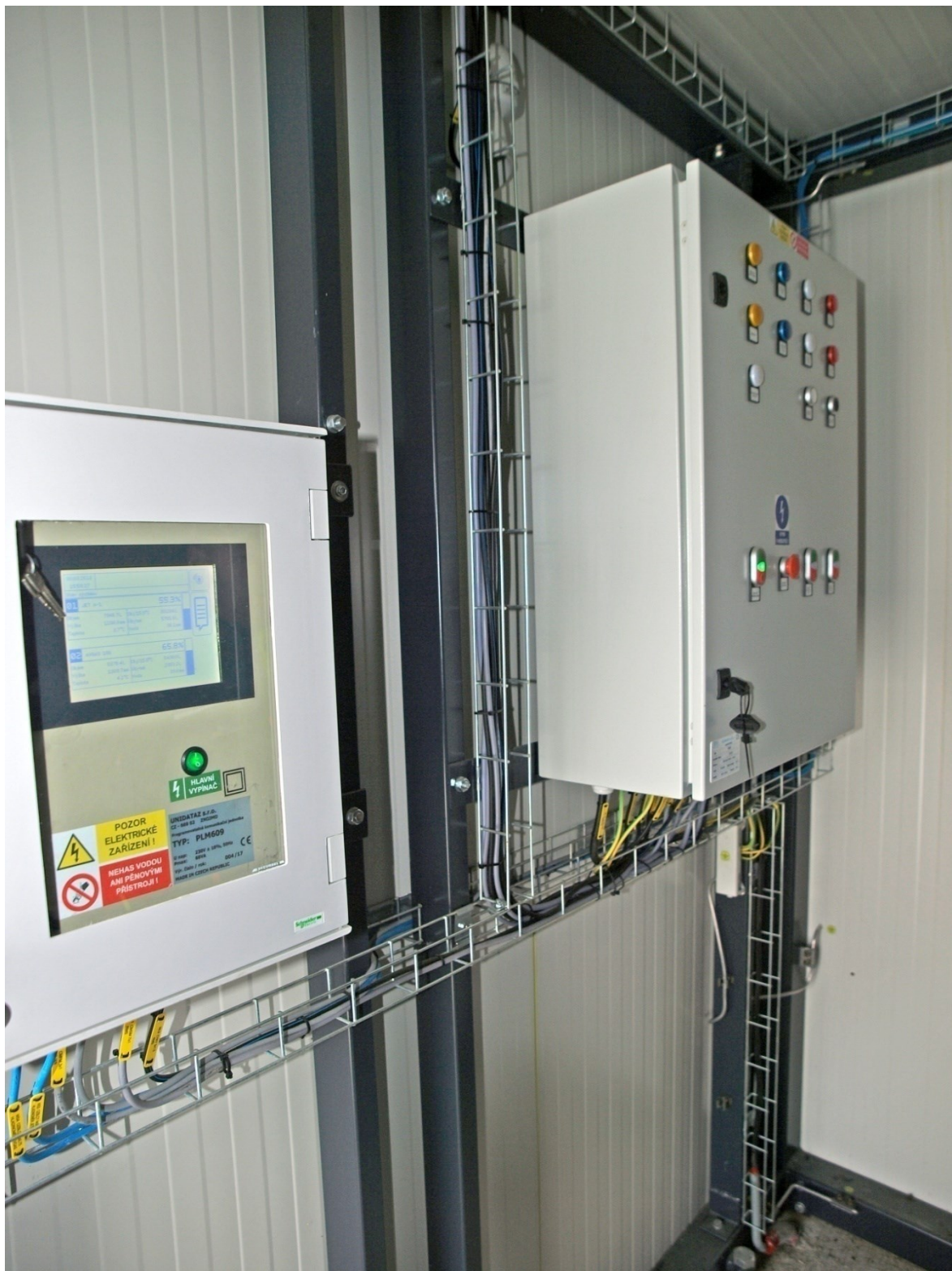
Obr. 16 Hlavní panel s ovládním čerpací stanice [Zdroj: vlastní]
