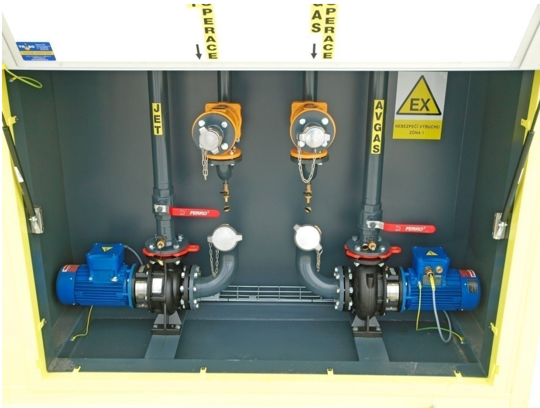
Obr. 13 Čerpadla čerpací stanice [Zdroj: vlastní]
