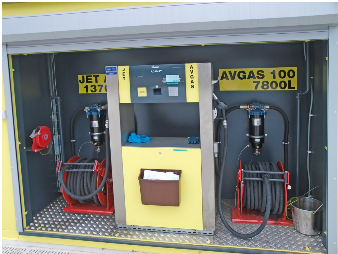
Obr. 14 Výdejní část čerpací stanice [Zdroj: vlastní]
