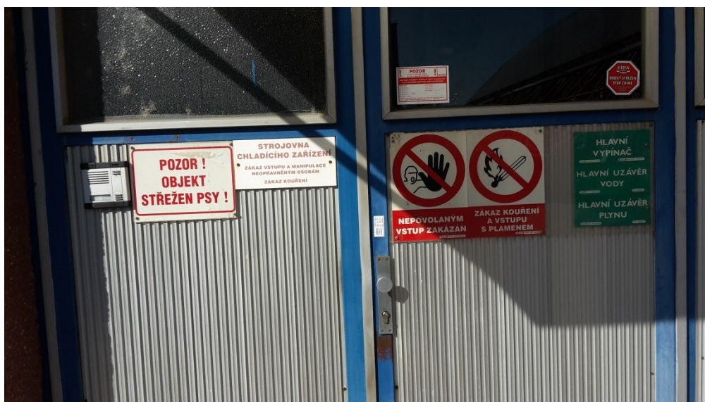
Obrázek 19 Vstupní dveře do strojovny chlazení
