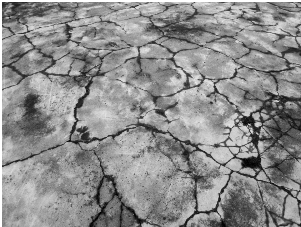
Obr. 23 Kresba prasklin na betonovém hřišti
