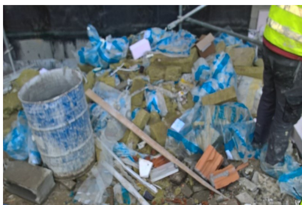
Obrázek 28: Nepořádek na staveništi [26]
