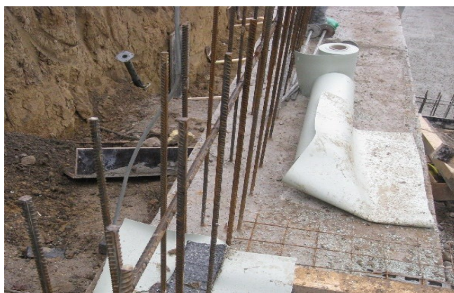
Obrázek 21: Nezajištění ocelových výztuží [26]
