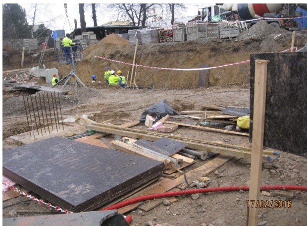
Obrázek 26: Špatné skladování materiálu [26]
