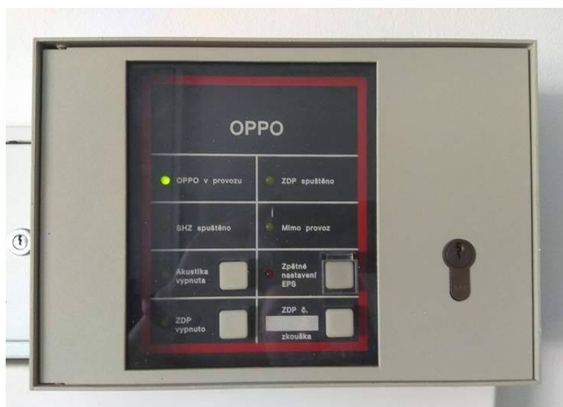
Obr. 7 Obslužné pole požární ochrany [vlastní zpracování]
