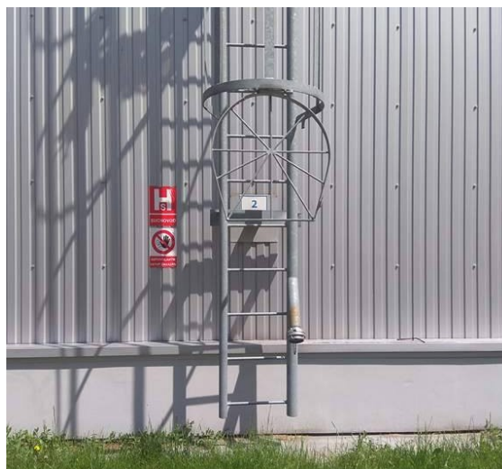
Obr. 11 Suchovod [vlastní zpracování]
