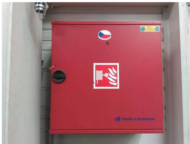
Obr. 9 Nástěnný hydrant [vlastní zpracování]
