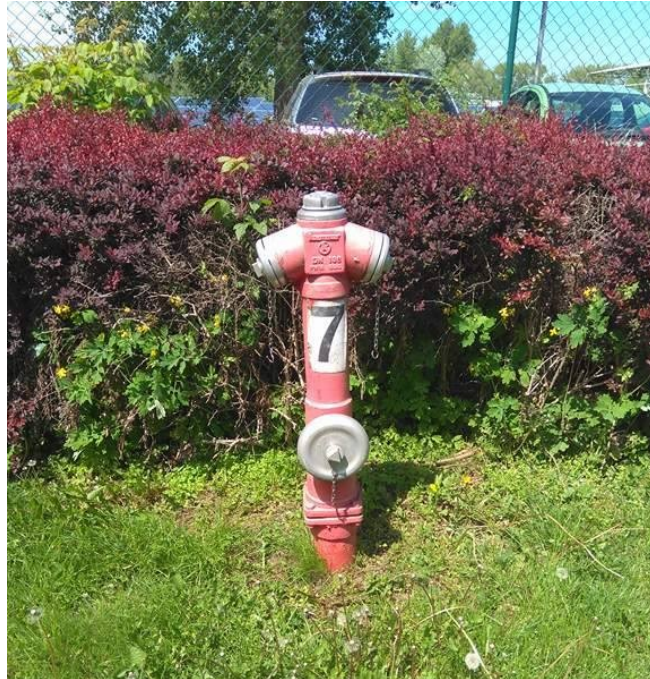
Obr. 10 Nadzemní hydrant [vlastní zpracování]
