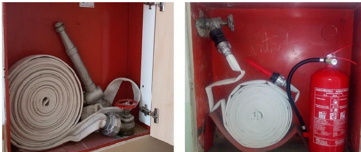
Obr. 20. Chybné zabudování ventilu (vlevo) vs. správná instalace ventilu (vpravo) [36]
