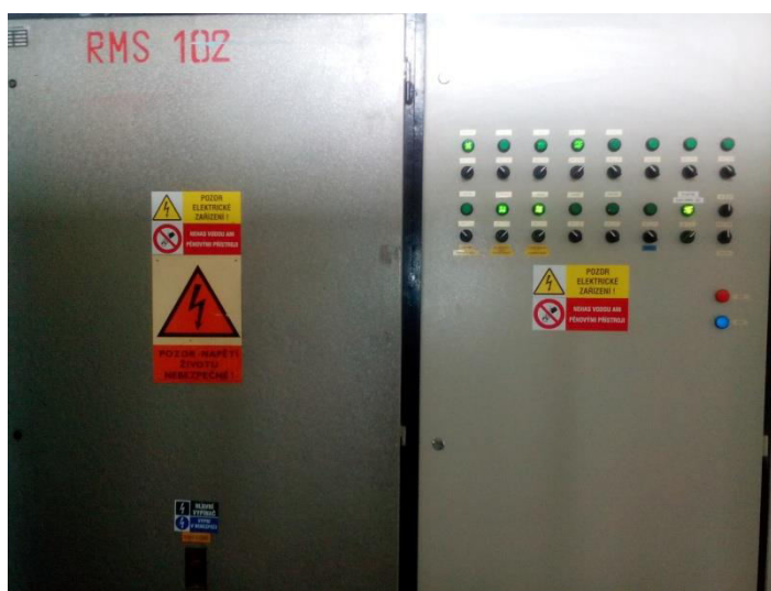
Obr. 7. Hlavní vypínač umístěn v zázemí údržby [36]
