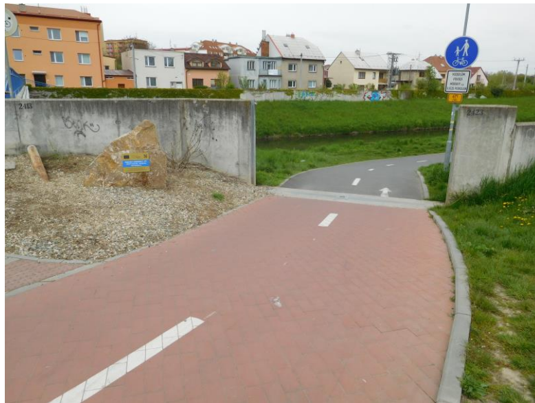
Obrázek 8: Protipovodňové stěny [Zdroj: vlastní]
