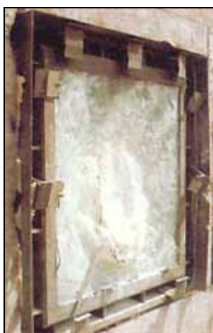
Obr. 9. Vnější strana okna po výbuchu. Po odhození krycích kovových elementů jsou dobře vidět obvodové expanzní průduchy
