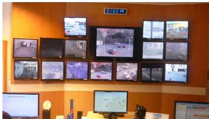
Obrázek 14 monitory kamerového systému
