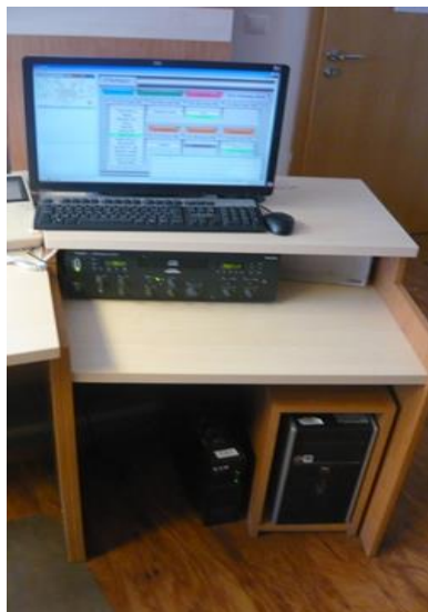
Obrázek 13 Pult centralizované ochrany ( C4)
