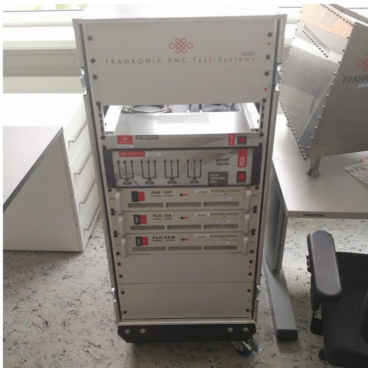
Obr. 19: Zostava zosilňovačov a systém prepínačov pre spínanie jednotlivých okruhov
