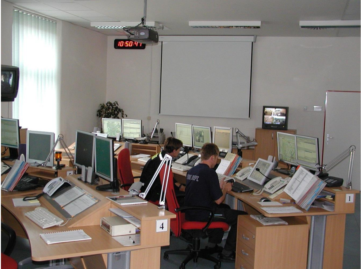
Obrázek 1: Příklad dohledového a poplachového přijímacího centra
