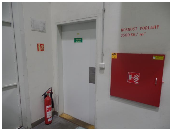
Obr. 28 – Požární ochrana podniku [Zdroj: vlastní]
