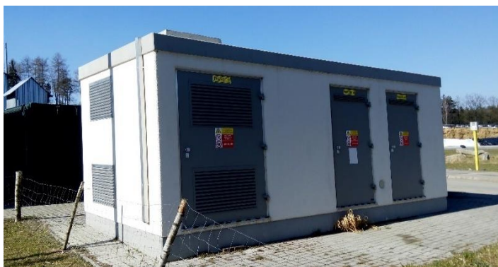
Obr. 10. Kobková trafostanice v Pěčíně [Zdroj: vlastní]
