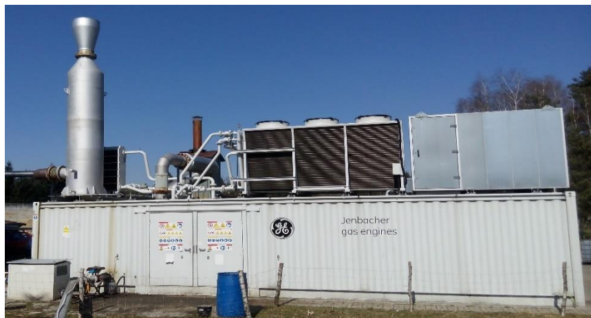
Obr. 8. Kontejner s kogenerační jednotkou v Pěčíně [Zdroj: vlastní]
