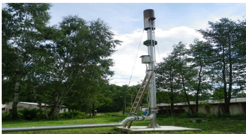
Obr. 9. Fléra pro nouzové spalování plynu v Pěčíně [Zdroj: vlastní]
