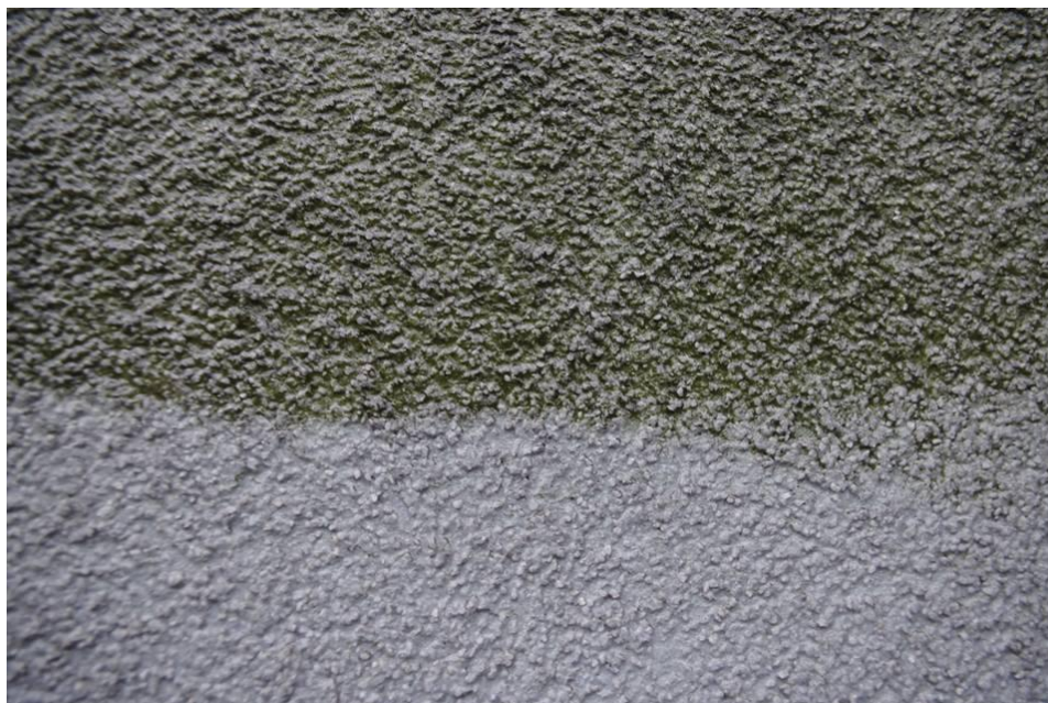
Obr. 3: Detail fasády znečištěné mikroorganismy před a po vyčištění
