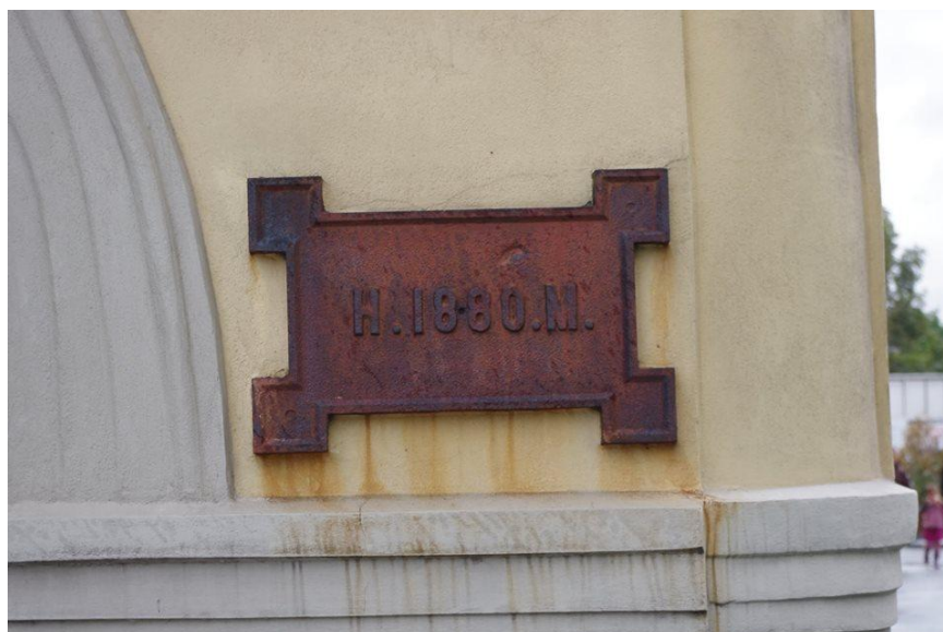
Obr. 2: Fasáda domu znečištěná korozí
