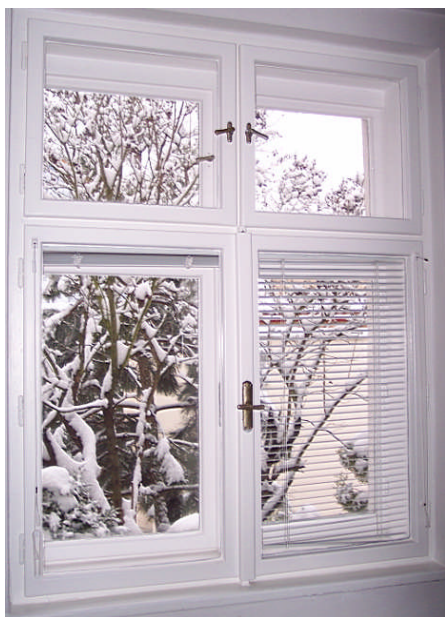
Obrázek 23. Jedno z nezabezpečených oken
