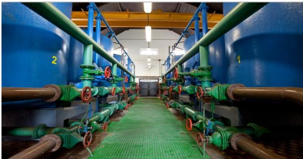
Obr. 8 Filtrační stanice v úpravně vod (interní materiály společnosti XYZ, a.s.)
