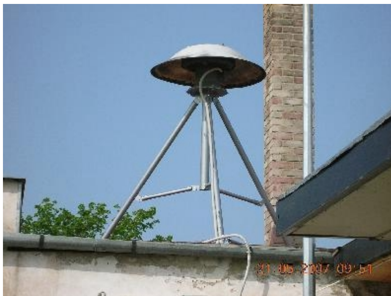
Obr. 2. Rotační siréna, (zdroj městská část Praha 3)
