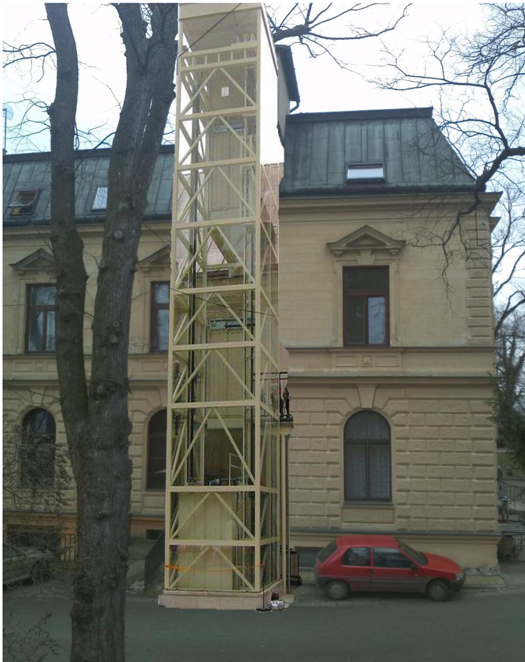
Obr. 20 Nový evakuační výtah [Zdroj vlastní]
